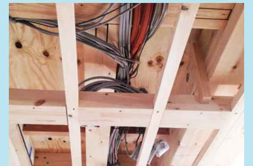
屋内配線の一例。床や壁の内側には電磁波を帯びた配線が張り巡らされています。その長さはなんと約800メートルにもなると言われています。
