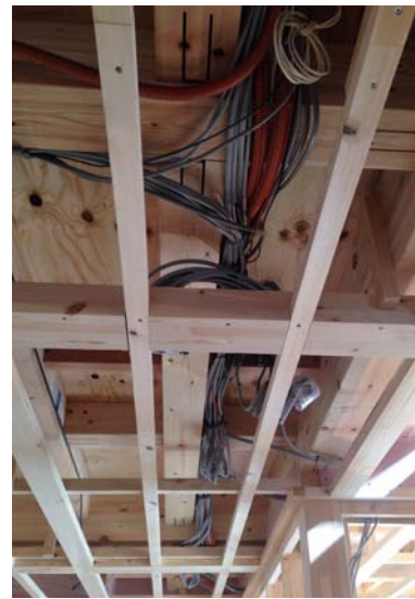
屋内配線の様子。
