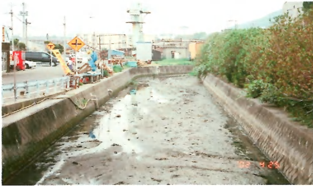
放流開始当時の干潮時の宇多田川 汚泥が堆積し、片側しか水が流れていない。
